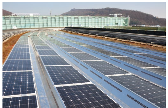
Solaranlage auf Flachdach
