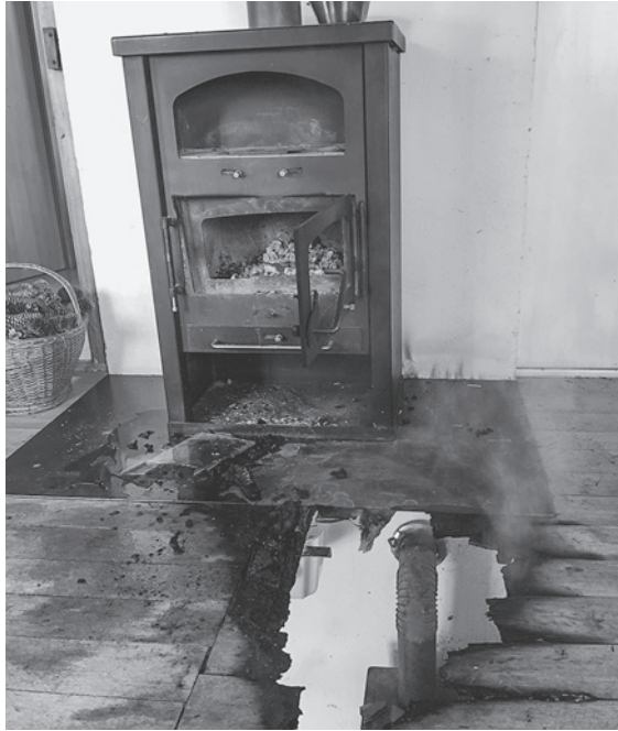
Deckendurchbrand infolge geborstenem Schwedenofen. (zvg)
